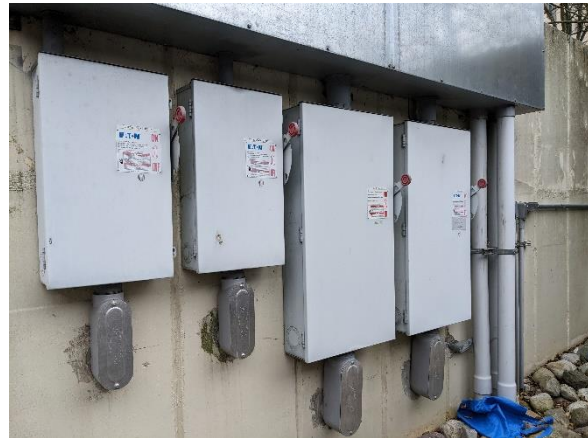
Disconnects for EM feeders
